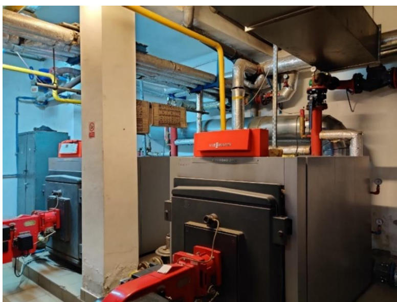
Foto 9. Centrala termică din Căminul nr. 1 – Cazane termice Viessmann Vitorond 200 cu arzătoare Weishaupt
