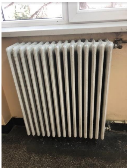
Foto 7. Cămin nr. 2. Radiator din fontă existent – fără reglaj
