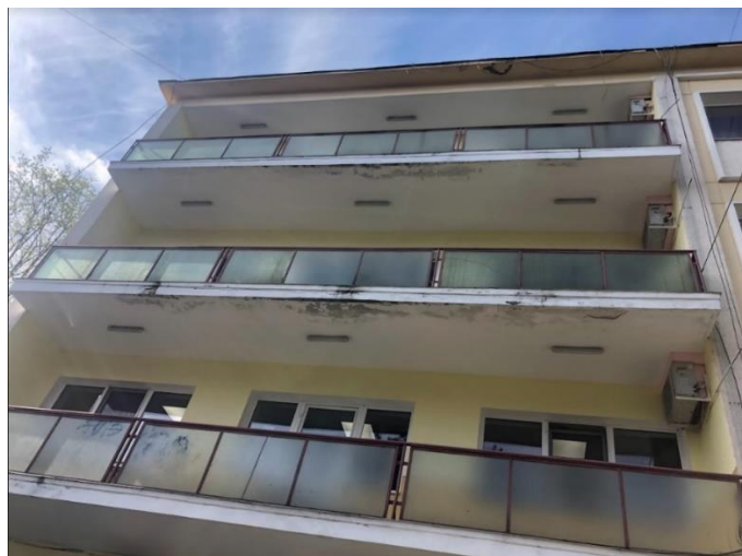
Foto 6. Degradări locale tencuială datorită infiltrațiilor –fațada NE
