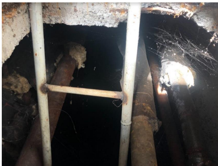
Foto 8. Cămin nr. 2. Conducte încălzire și a.c.m. în subsol tehnic
