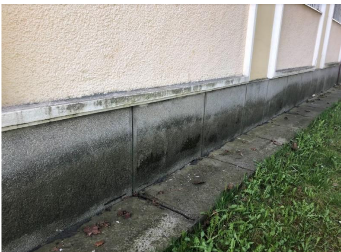
Foto 5. Cămin nr. 2 - Igrasie pe fațada NE
