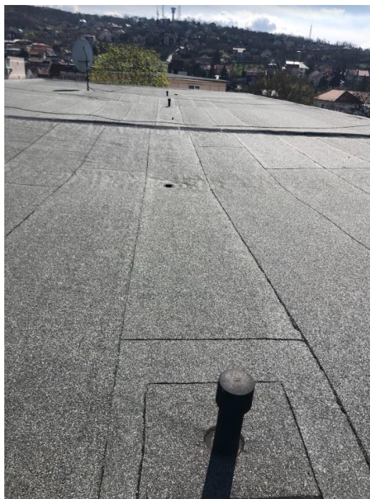
Foto 4. Cămin nr. 2 – terasă necirculabilă peste ultimul nivel
