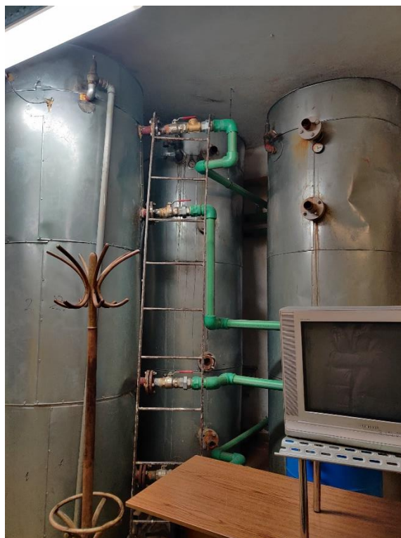
Foto 11. Centrala termică din Căminul nr. 1 – Acumulatori a.c.m. (doar cel din stânga e funcțional)
