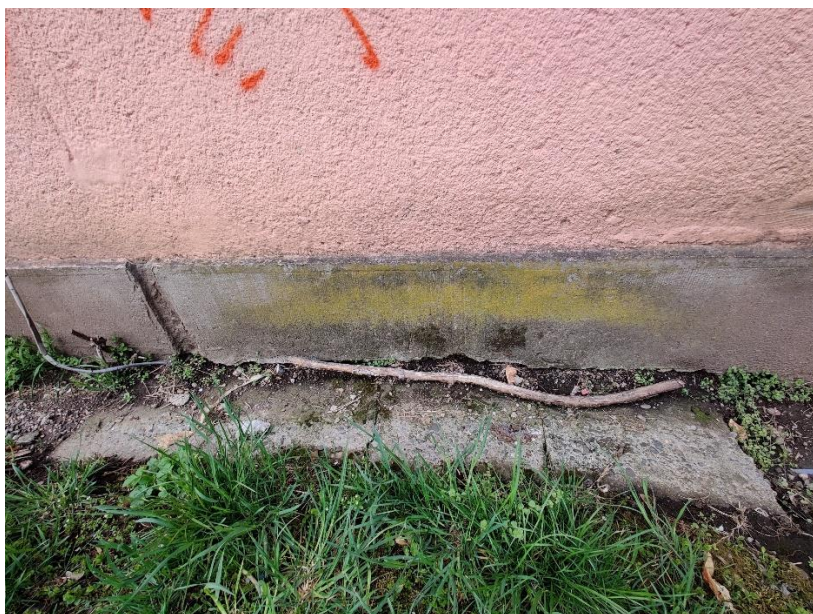
Foto 5. Cămin nr. 4 - Igresie pe fațada SE și degradări locale trotuar
