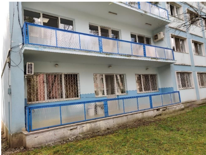
Foto 5. Igrasie pe fațada NE și degradări locale soclu
