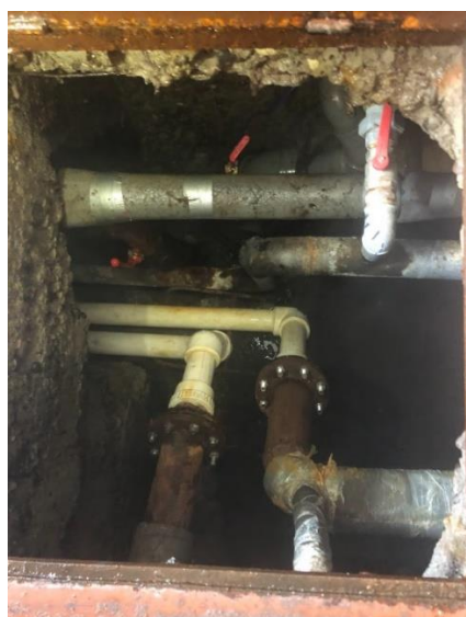
Foto 9. Cămin nr. 3 - Conducte cu pierderi de agent termic în subsolul tehnic
